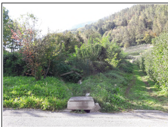
Foto 6.1.1 – Pozzetto a dispersione a quota 737 m s.l.m., posto in prossimità della strada comunale che collega l'abitato di Monclassico con quello di Croviana.
